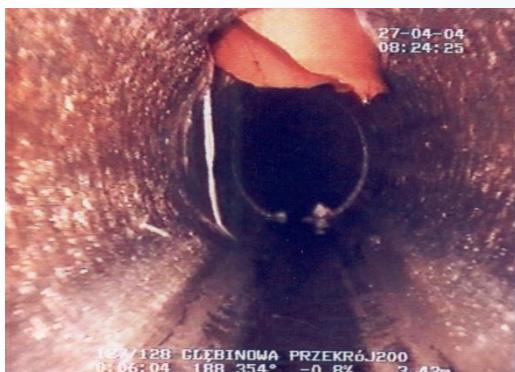
Niewłaściwe włączenie przykanalika
