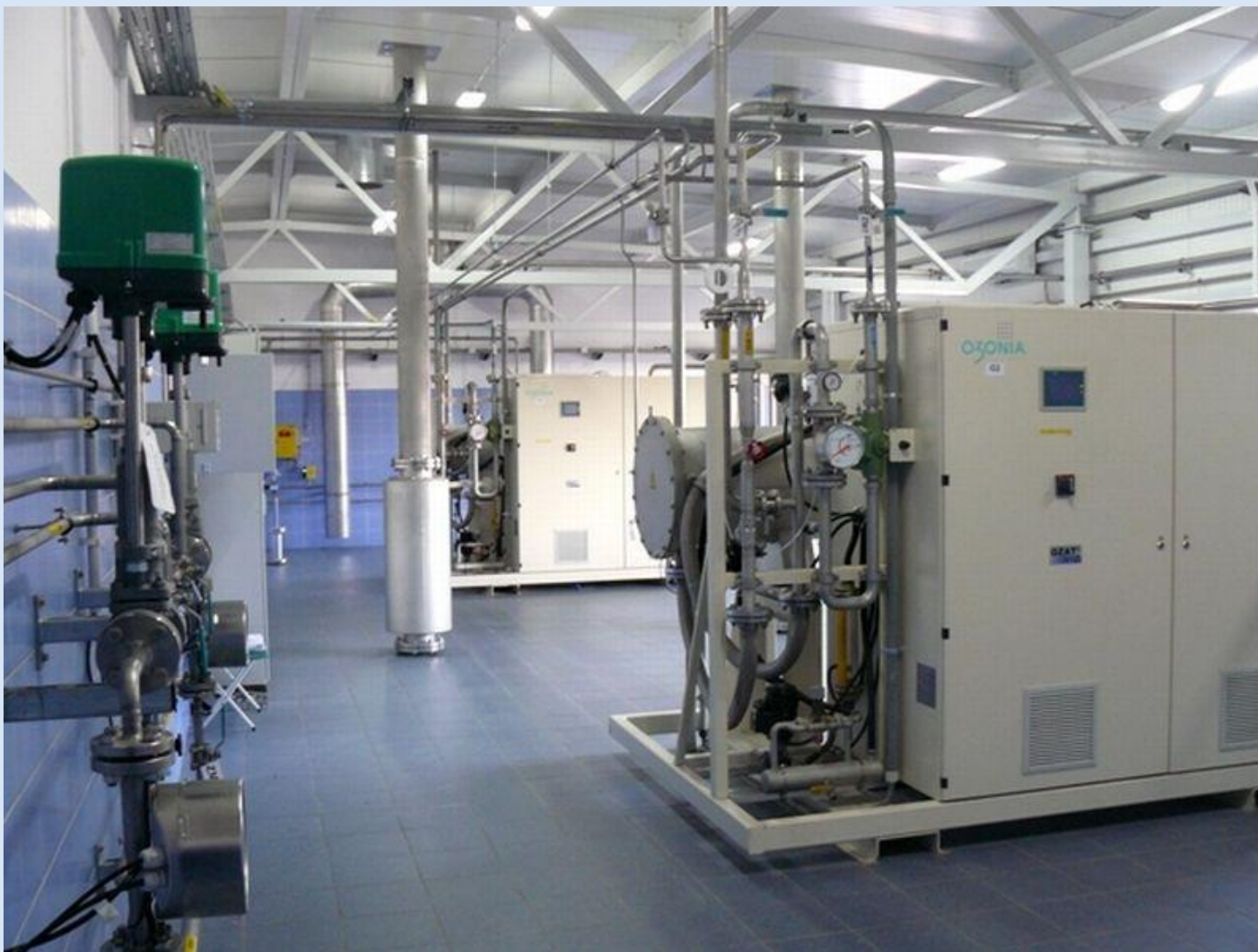
Fragment hali generatorów ozonu
