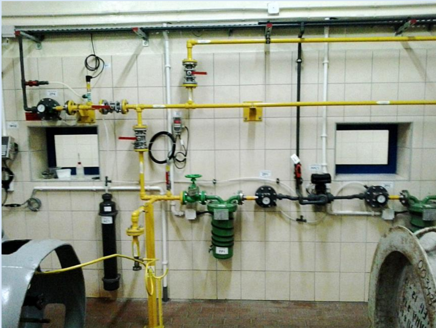
Fragment instalacji chlorowania wody (dezynfekcja wody)
