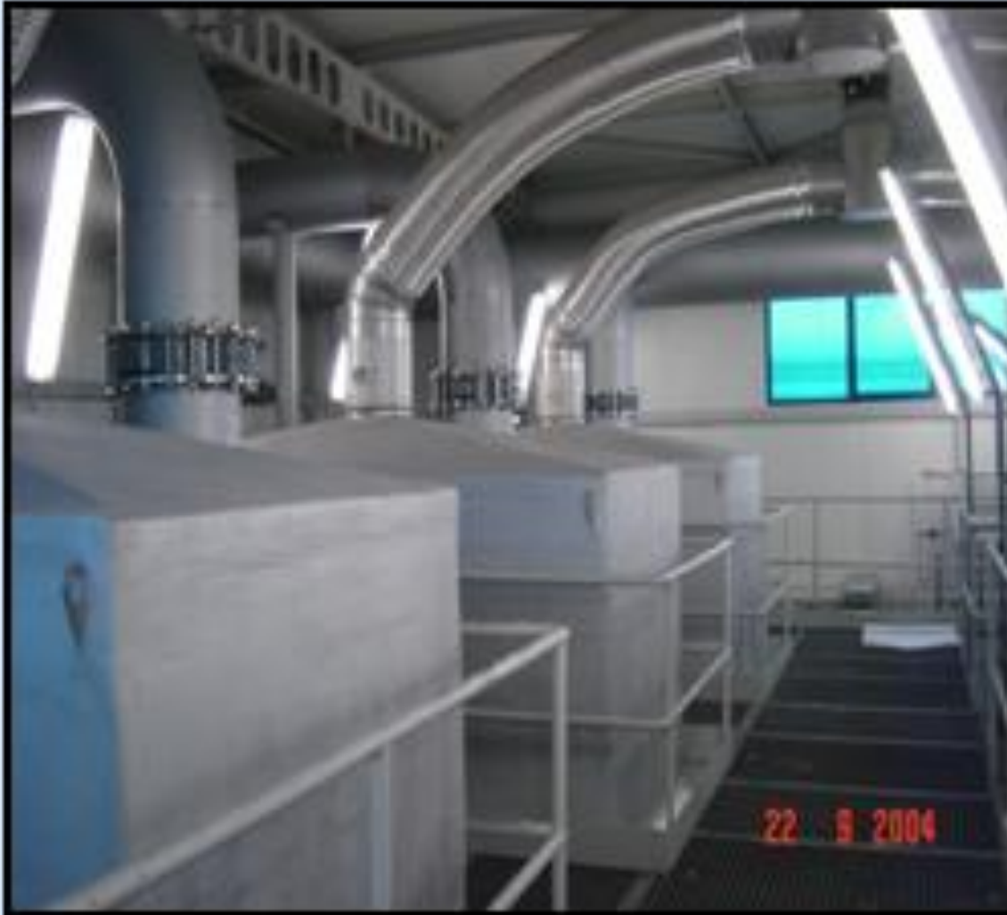
Fragment hali aeratorów kaskadowo-rurowych napowietrzania wody
