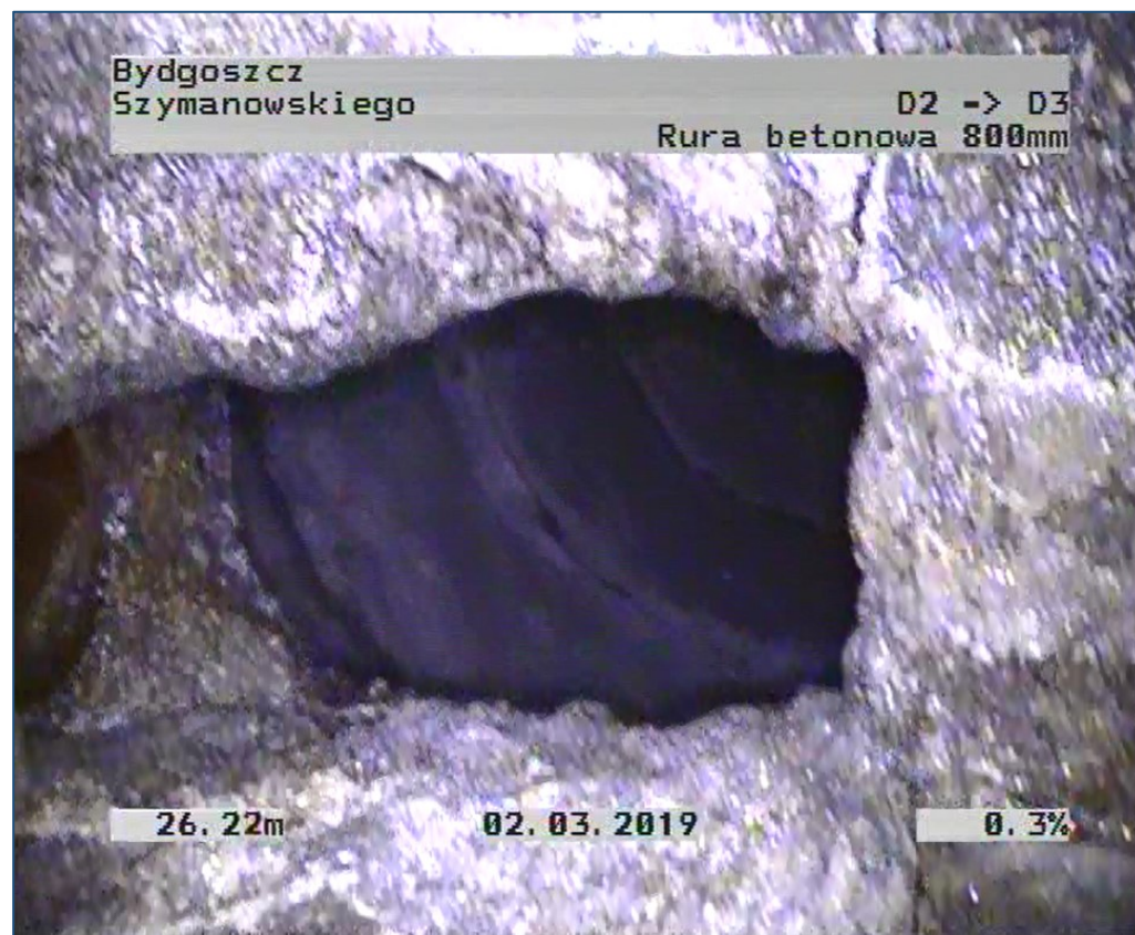
ul. Szymanowskiego - nieprawidłowo zabudowana studnia na kanale
